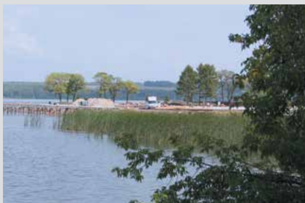
На Беловском «море» идут работы в бухте «Ассоль» — беседки на воде, зона для прогулок, парковки. Здесь пройдут этап Кубка России по триатлону и этап Кубка мира по X-Waters
